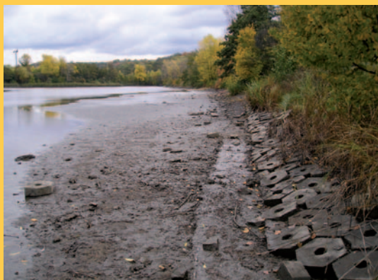
Původní poškozené opevnění břehů
