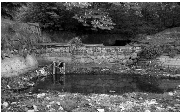
Původní poškozený přeliv
